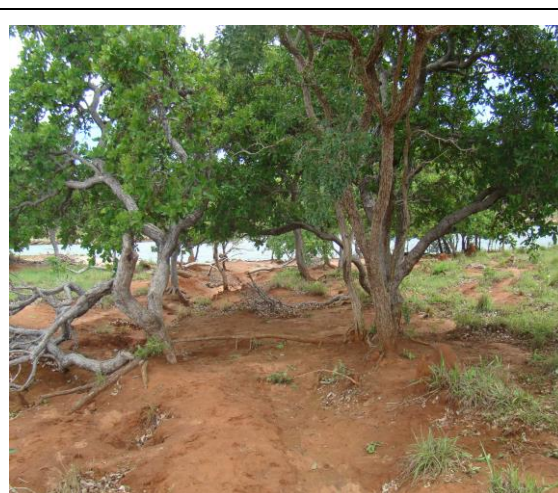
Foto - 6. Vista parcial processo erosivo PE5 na sua parte inferior, dentro da APP.
