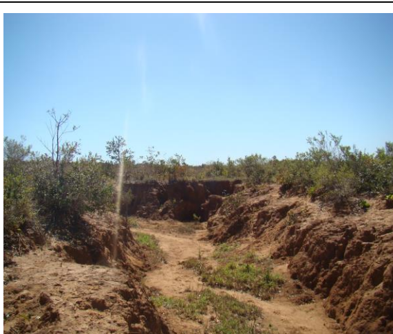
Foto - 7. Vista parcial do processo erosivo PE3 na sua parte mediana, ainda dentro da APP.
